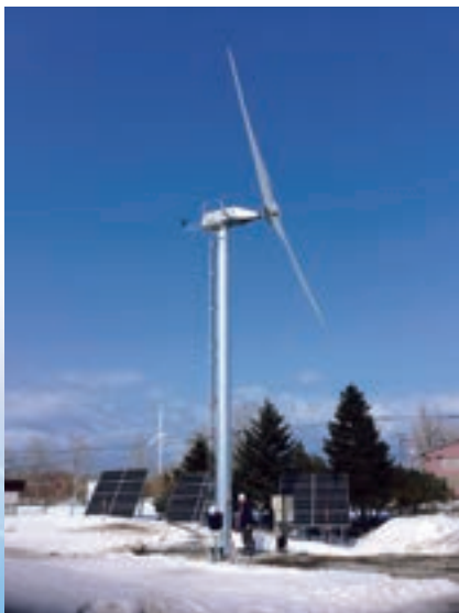
▲ 北弘電社テクノセンターに設置した小型風力発電機
