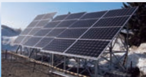
▲ 太陽光発電実証施設（北弘電社テクノセンター敷地内）
