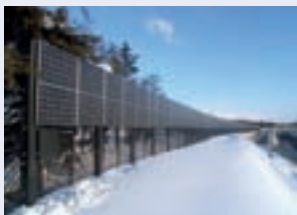
▲ 札幌ドーム太陽光発電設備
